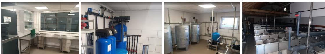
rys/fot. 9.2 Obiekt doświadczalny Salmocross – zaplecze techniczne
